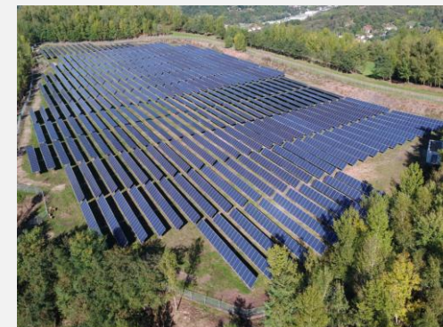
Centrale Solaire de Decazeville Département de l'Aveyron (12) Puissance électrique : 11 400 kWc Mise en service : 2017
